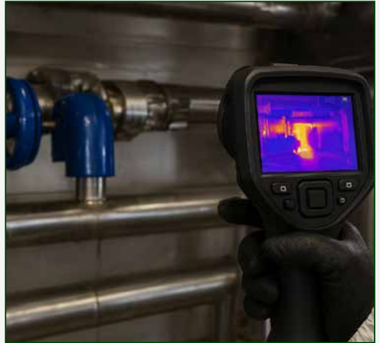
Detección de incidencias
