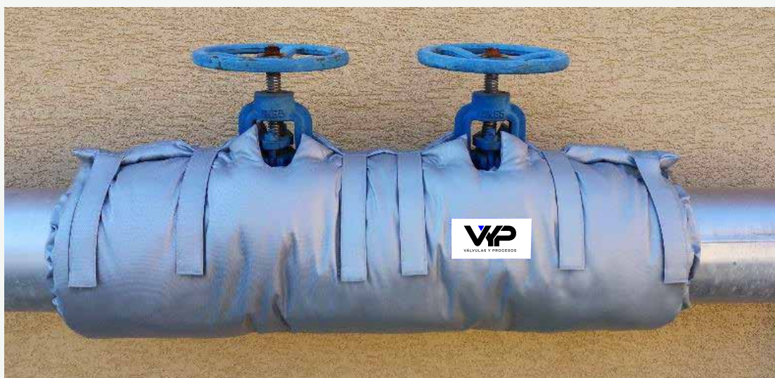
Válvulas para vapor
