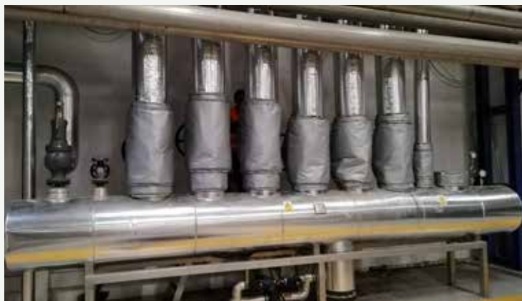
Colectores de distribución
